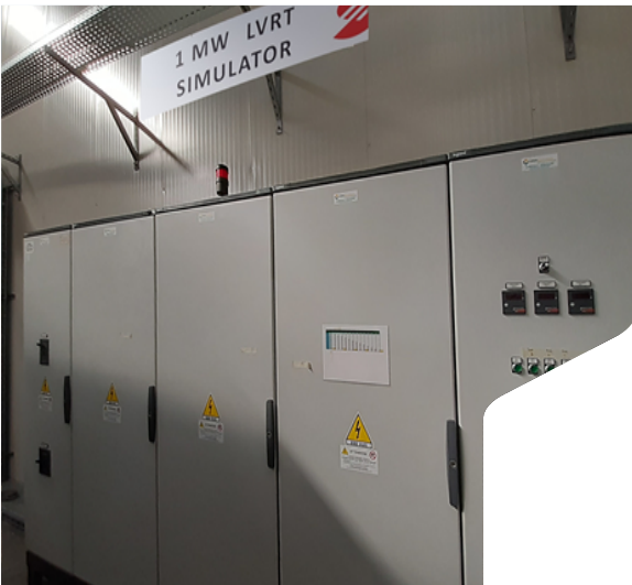
Figura 2 – Simulatore e banco di test LVRT da 1 MW
