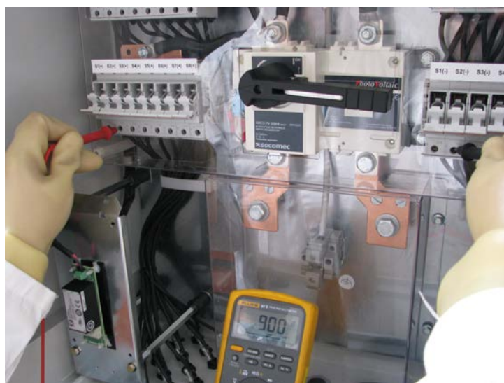
Figura 22: Punti di misura della tensione ai capi delle stringhe (verifica della stringa 2: montaggio corretto)
